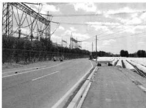
工事が中断している新地の変電所付近
