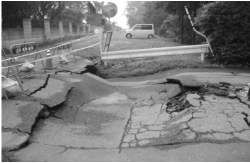
道路陥没発生時の状況
