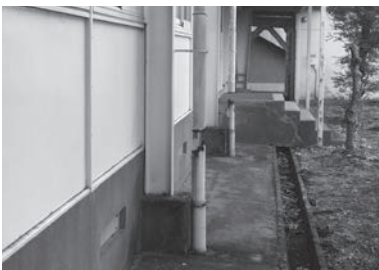
途中で割れている雨どいの管 (安静小学校体育館)
