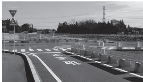
一部が未整備の県道つくば古河線バイパス (古河市名崎)
