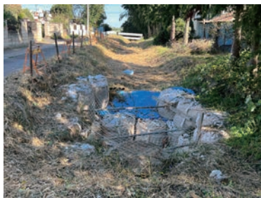
コルゲート管陥没現場
