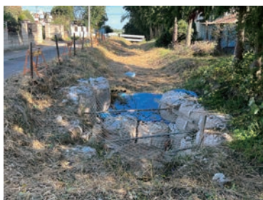
コルゲート管陥没現場
